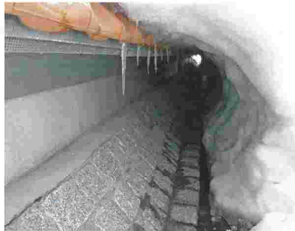
Dank der nützlichen und energiesparenden „Rinnenheizung“ entsteht unter den Schneebergen zwischen Traufe und Pflasterrinne ein Hohlraum, der die notwendige Hinterlüftungsebene der Dachkonstruktion offen hält
